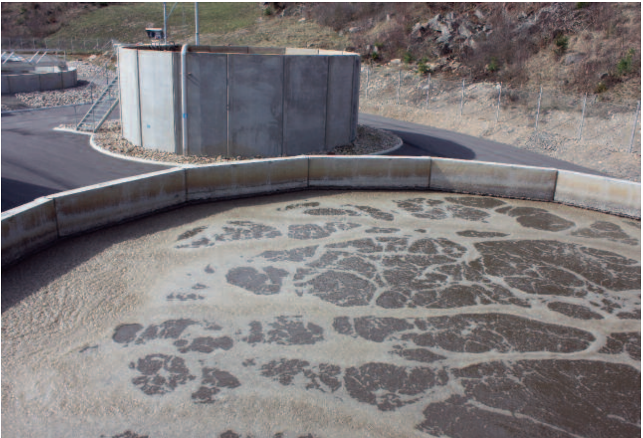
Reningsverk för 7 400 i ett samhälle med 850 invånare, Ullared.
